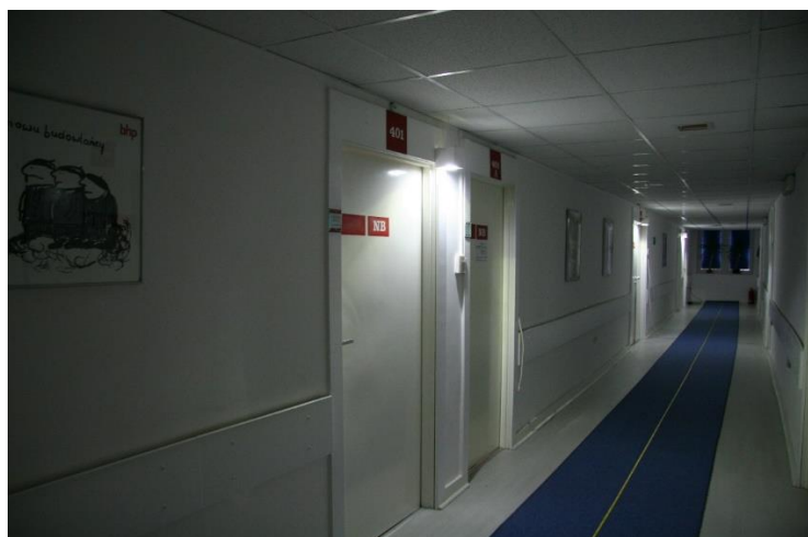
Rys. 6.6. Widok korytarza z zamontowanymi oprawami KWADRA SIDE N AT 1J LED 3 firmy HYBRYD
