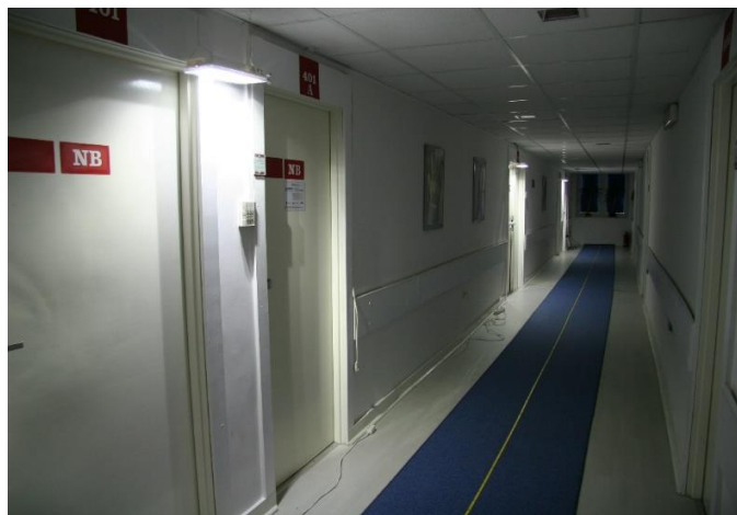
Rys. 6.5. Widok korytarza z zamontowanymi oprawami HERKULES-P ROAD AT 1J LED 5 firmy HYBRYD
