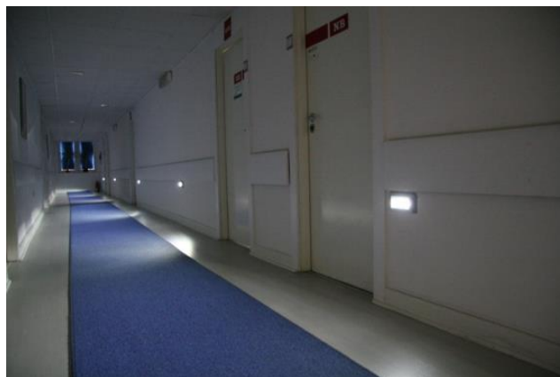
Rys. 6.2. Widok korytarza z zamontowanymi oprawami ORILED 760 firmy ZUMTOBEL
